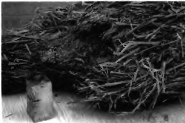
10.3-4 Фрагменты прогнившей стены из легкого глинобетона на органическом заполнителе (солома)
