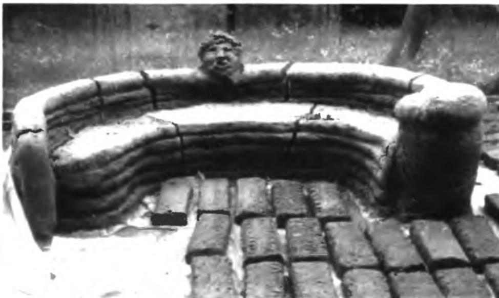
8.1-2 Усадочные трещины после высыхания
