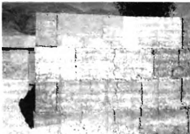
5.4-1 Усадочные трещины в монолитной глинобетонной стене, Эквадор
